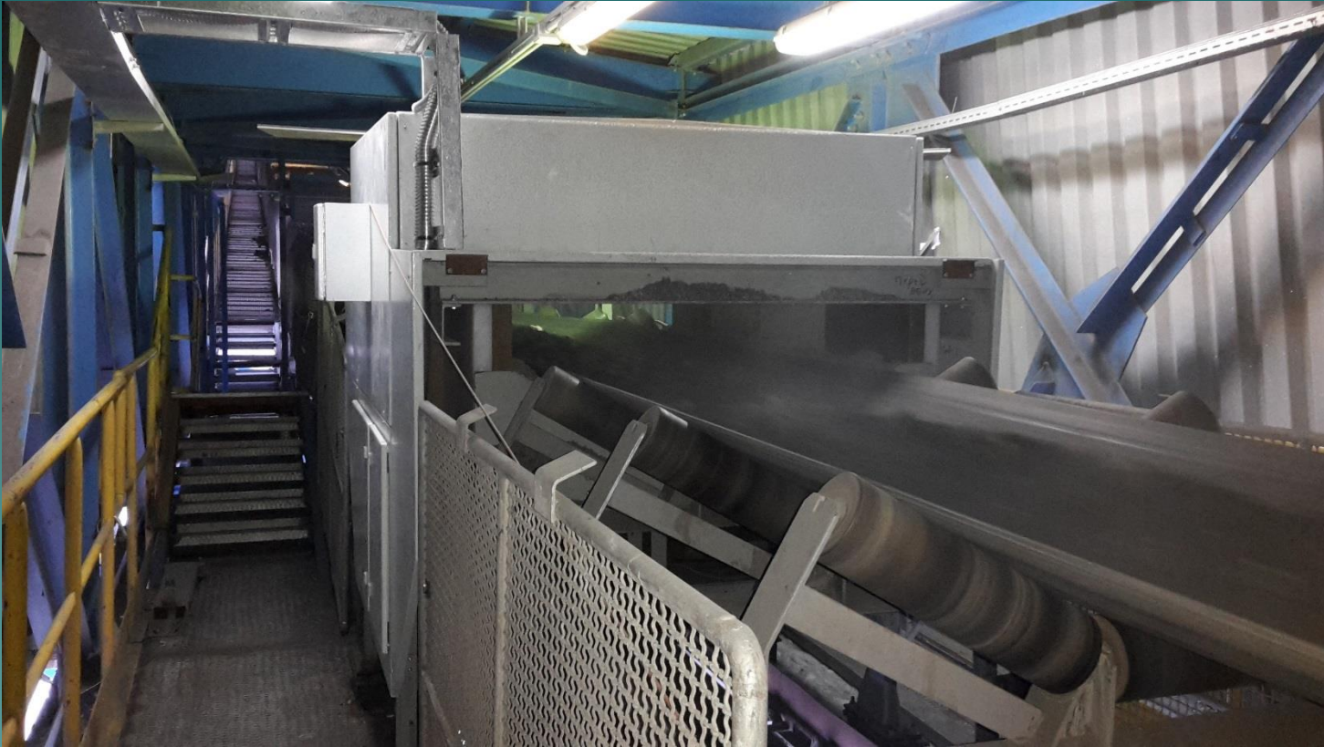
Фото установки АСЦС-1000 группы компаний "Ратэк" на цементном заводе "Петербургцемент"
